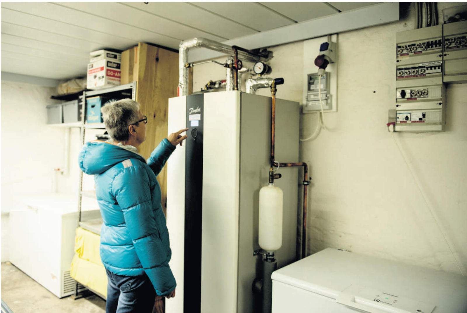
Temperaturen i huset reguleres ikke længere på varmeapparaterne, men på kedlen i bryggerset.
